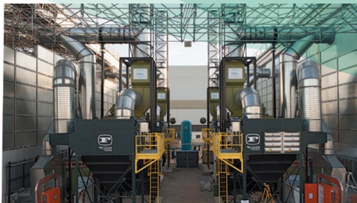
Filtrering af luft fra sandblæsning på skibsværft
