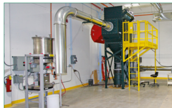
Teststand zur Staubprüfung nach ASHRAE-Norm 199
