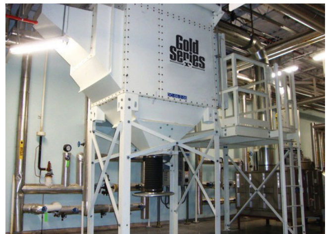
Beispiel für die Installation einer typischen Absauganlage.
